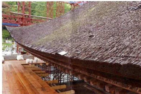
5重屋根 軒先 軒先の腐朽や破損、竹釘の露出が確認できる。
